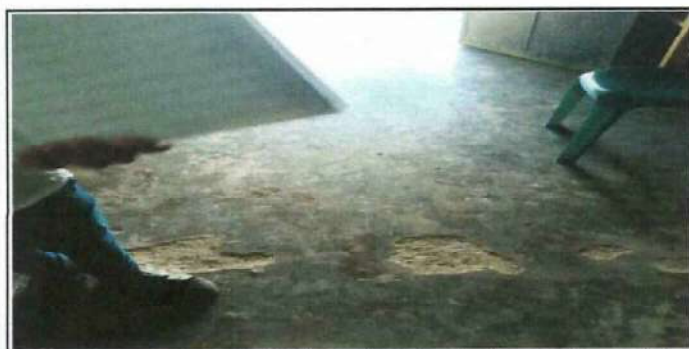
Foto 5: Se observa la necesidad de la colocacion de piso ceramico en el piso de las aulas.
