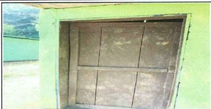
Foto 1: Se observa la necesidad de la sustitucion de la puerta de la entrada de una de las aulas.
