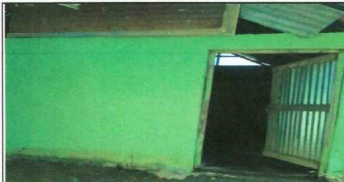
Foto 2: Se observa la necesidad de la sustitucion de la puerta de la entrada de una de las aulas.
