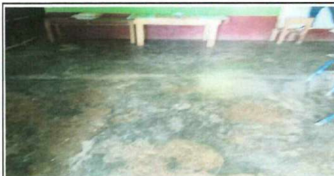
Foto 4: Se observa la necesidad de la colocacion de piso ceramico en el piso de las aulas.
